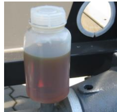
Abb. 16 Ölbehälter für Schmierung der Spülpumpe
